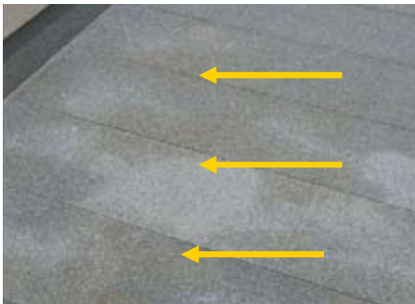
Abbildung 1: Blick auf einen Teil des Natursteinverbundes. Es sind optisch sichtbare rötliche bis bräunliche Verfärbungen / Flecken zu erkennen (mit Pfeilen markiert).
