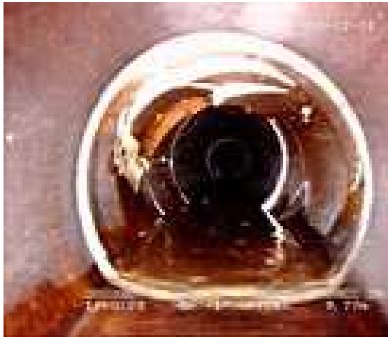
Abb1: Streckenschaden mit Radial- und Längsris
