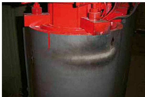
Bild 7: Spuren eines Windungsschlusses an einem Gießharztransformator
