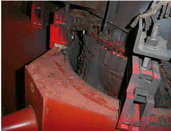
Bild 8: Verbrannte Unterspannungswicklung eines Gießharztransformators
