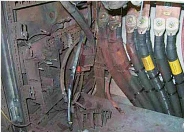
Bild 4: Niederspannungsschalterschrank nach einem Lichtbogen
