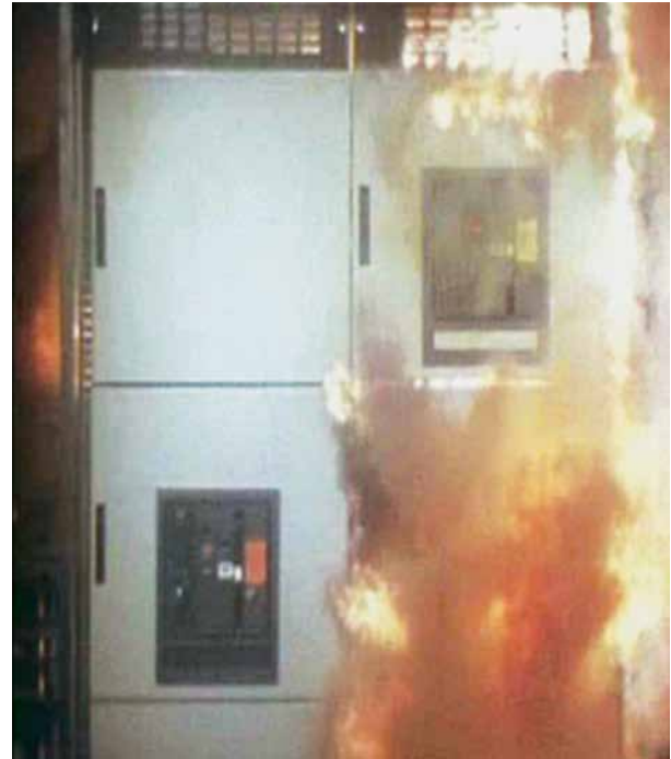
Bild 3: Störlichtbogen in einem Niederspannungsschaltfeld
