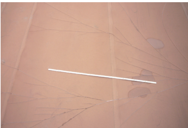
Abbildung 1: Oberseite der Dach-Beschichtung mit sichtbaren Rissystemen
