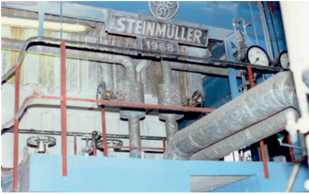
Bild 3: Dampfzeuger, schwerölgefeuert (Detail)
