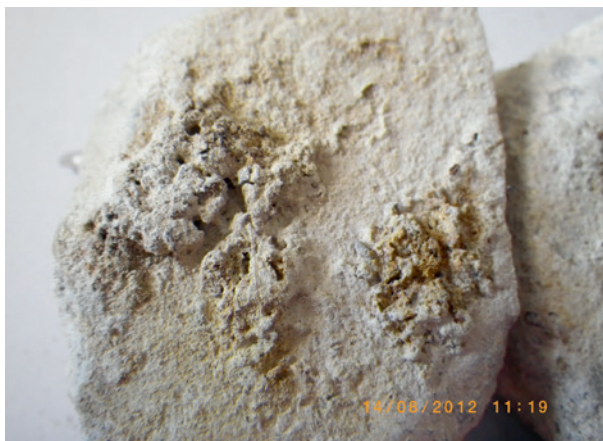
Abb. 1: Bohrkern aus einem Bereich mit der höchsten Säurebelastung in der Draufsicht
