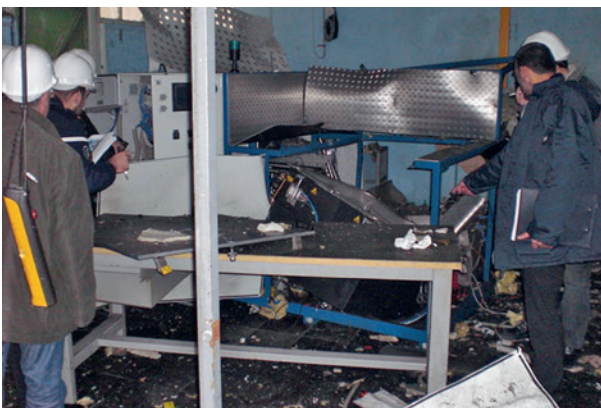
Bild 2: Vom Schaden betroffene Anlage
