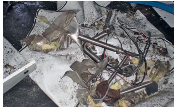
Bild 3: Teile der Wasserdampfheizung
