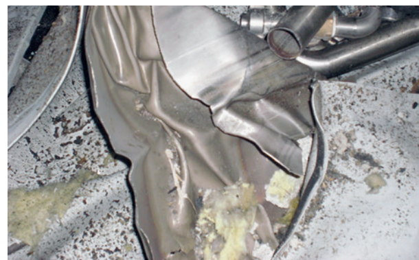
Bild 4: Detailansicht des Heizungsmantels, welcher aufgrund äußerer Krafteinwirkung gequetscht und gefaltet
