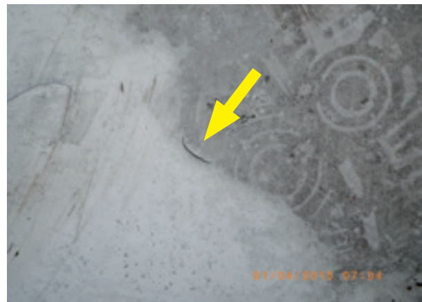
Abb.2: Bereich, der an der Oberfläche eine makroskopisch deutlich sichtbare Beschädigung an der Oberfläche, an der Grenze zwischen dem hellen und dunklen Bereich (Pfeil) aufweist.
