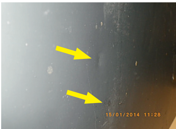
Abb. 3: Probe 1 eines Fassadenteils aus Metall, mit deutlich sichtbaren Beulen (Beispiele mit Pfeilen markiert).
