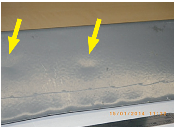
Abb. 4: Probe 2 eines Fassadenteils aus Metall, mit deutlich sichtbaren Beulen (Beispiele mit Pfeilen markiert).
