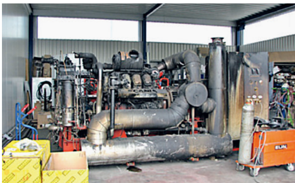
Bild.1: Gesamtansicht des BHKWs ohne Schallschutzcontainer
