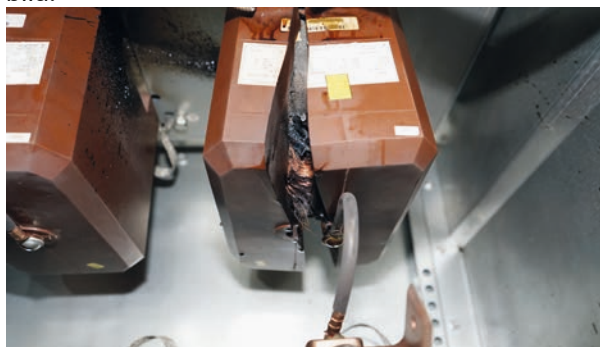
Bild 2: Geborstener Spannungswandler in einer Mittelspannungsschaltanlage
