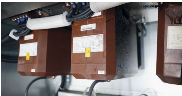
Bild 1: Spannungswandler in einer Mittelspannungsschaltanlage
